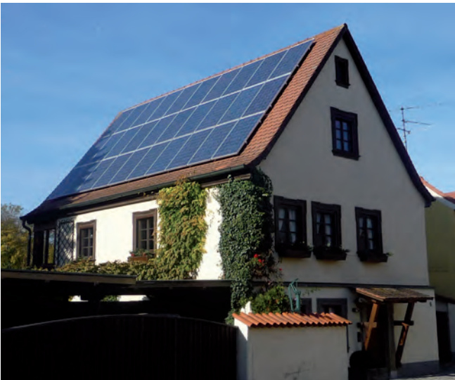
Beispiele für Photovoltaikanlagen in Gerolzhofen
